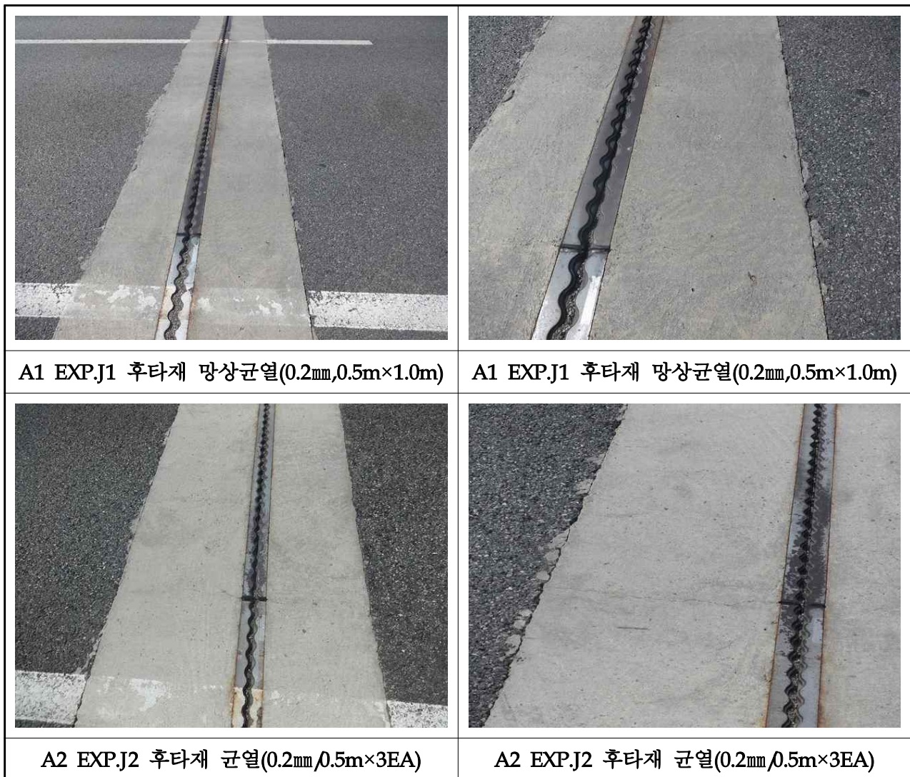
【사진 3.17】 신축이음장치 손상현황
