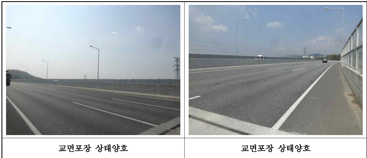
【사진 3.20】 교면포장 손상현황
