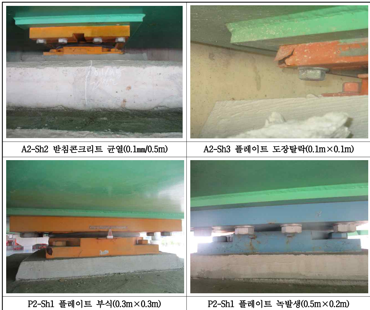
【사진 3.14】 교량받침 손상현황
